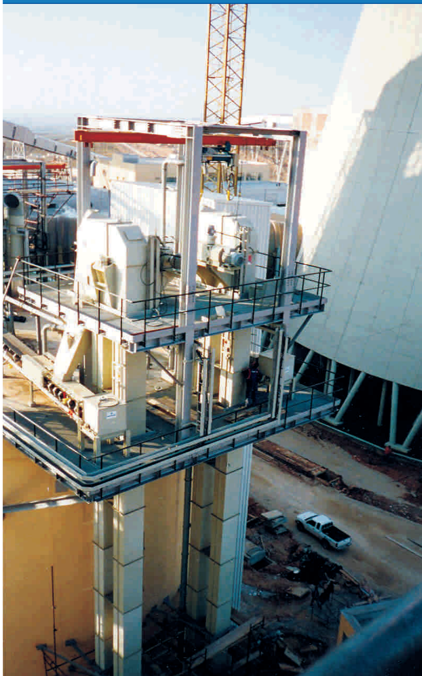
Grecia - Centrale termoelettrica Greece - Power plant
