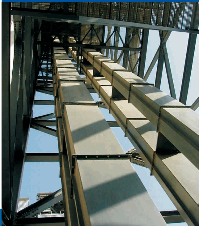
Bahrain - Impianto calcinazione coke di petrolio Bahrain - Coke calcining plant
